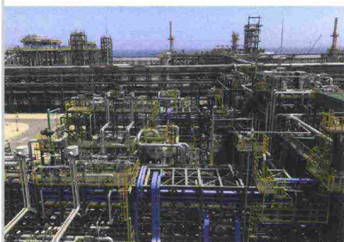
IL COMPLESSO DI TRATTAMENTO GAS DI ZOHR, IN EGITTO, PER CUI KT STA REALIZZANDO ALCUNE UNITÀ DI PROCESSO
